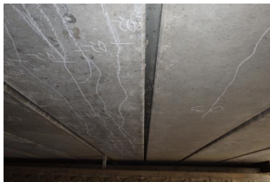
橋桁下面のひびわれ
