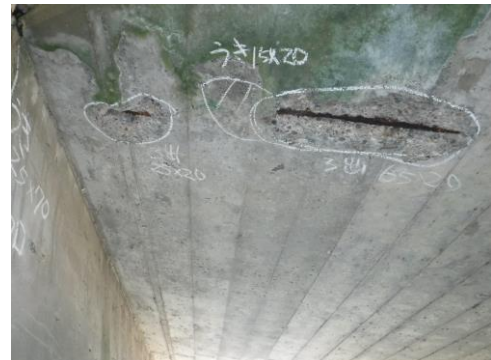
コンクリート主桁の鉄筋露出
