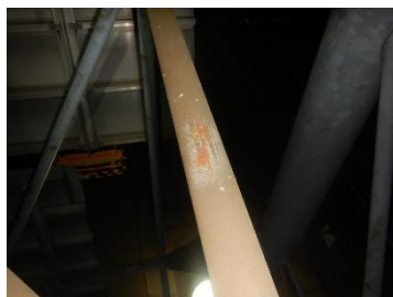
横梁本体の局所的な腐食
