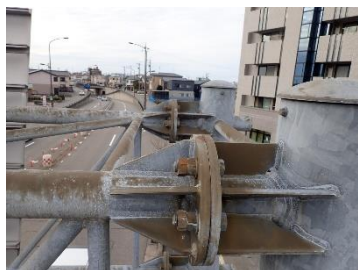
横梁継手部の局所的な腐食
