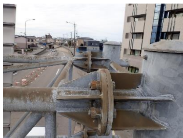
横梁継手部の局所的な腐食
