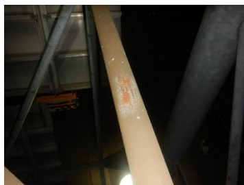
横梁本体の局所的な腐食
